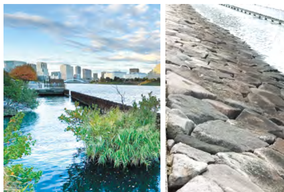
荒れた浮島と進入禁止の親水エリア
